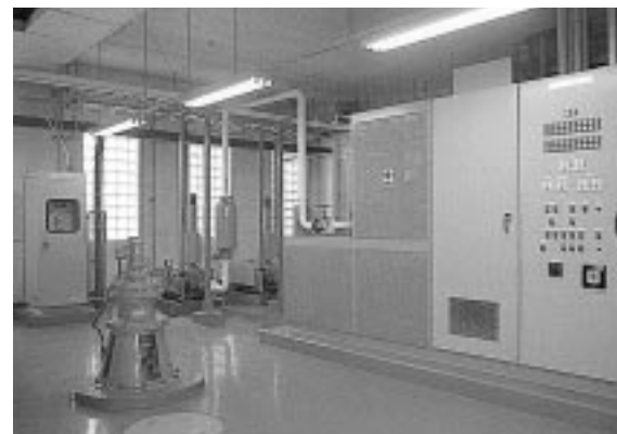
オゾン発生装置
